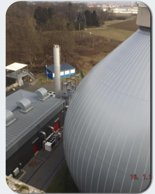
Wasserverband Eifel-Rur Kläranlage Mühlenweg DN
